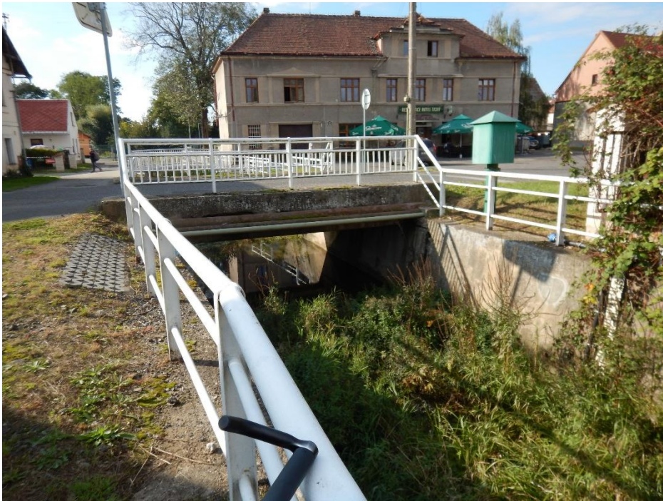
Obrázek 3 Obdélníkové koryto v intravilánu Hošťky a nekapacitní most PF_33_M (ř. km 5,853)
